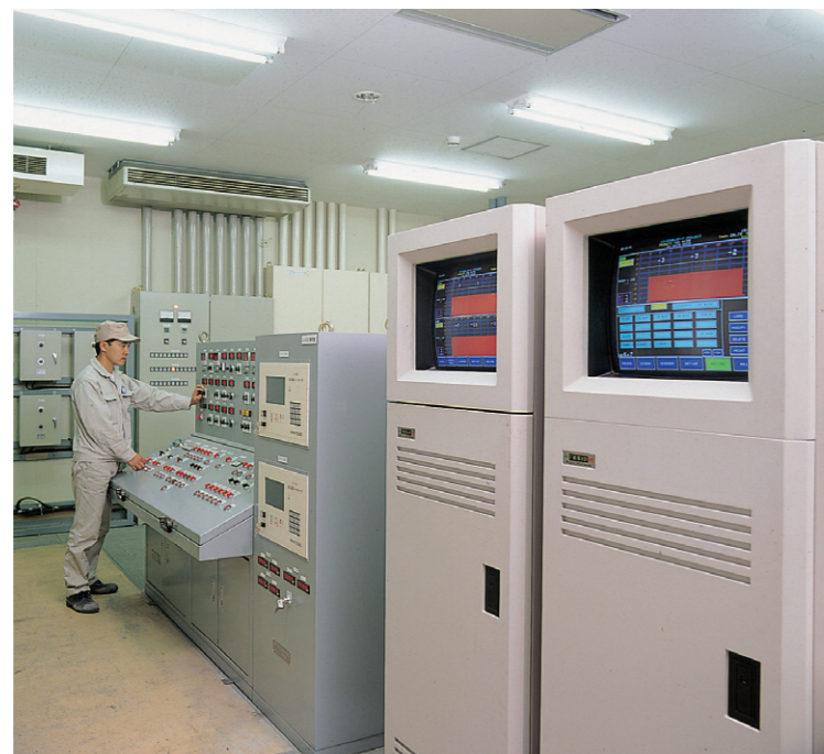
〈研磨布製造装置・制御室〉
