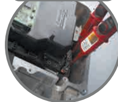
作業前の電圧測定は車両メーカーの整備指示書に指定されています。
